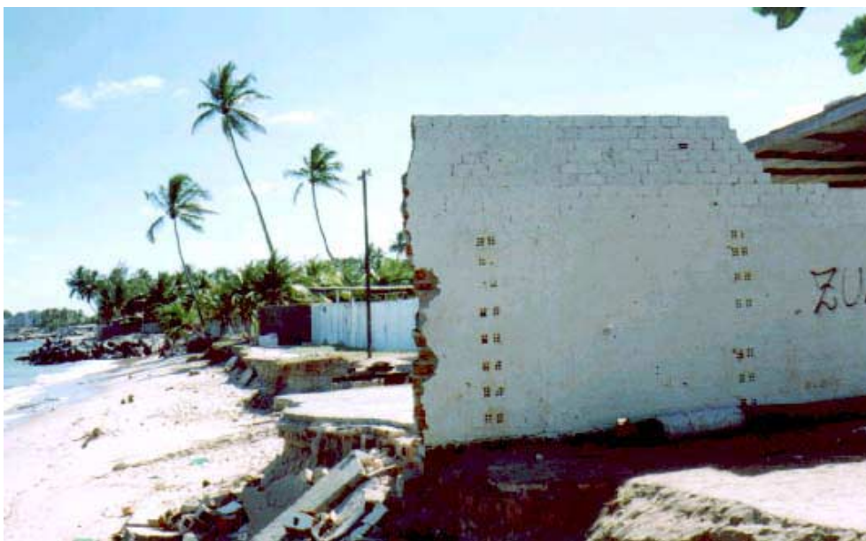
FOTO 51 – Muro da Marina Costa Azul, na praia do Janga (Paulista), destruído pela erosão marinha.
