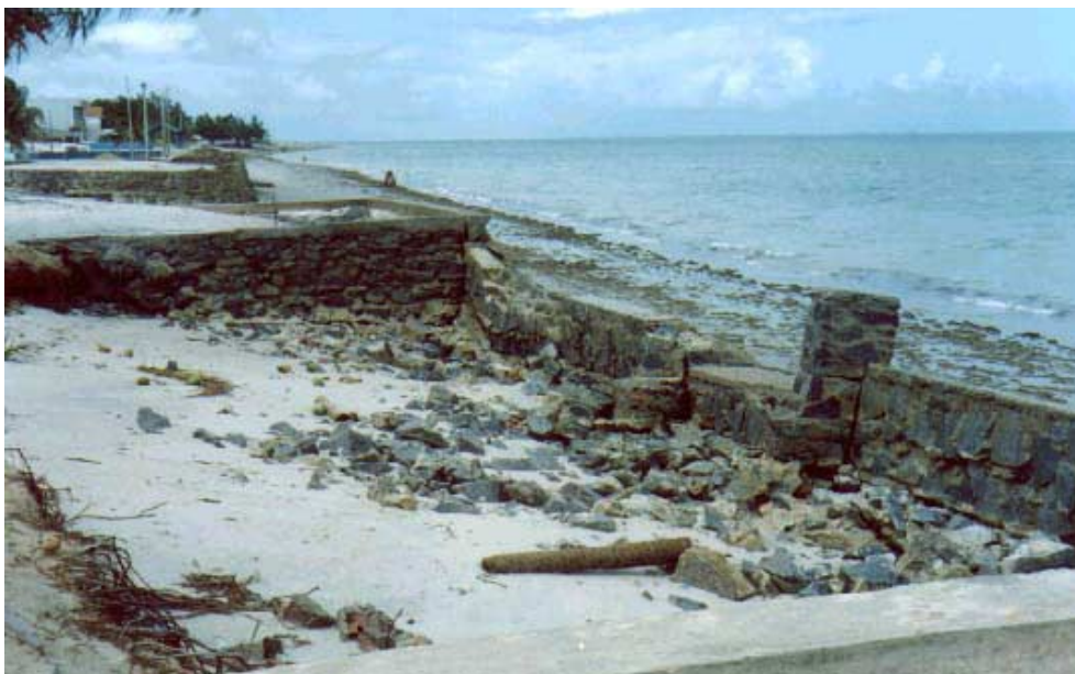
FOTO 50 – Muros de contenção destruídos pela erosão marinha, na Praia de Forno da Cal (Itamaracá).
